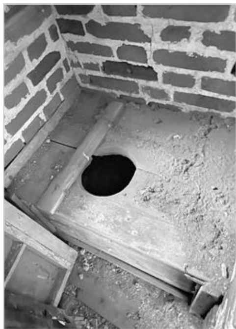
Ил. 2. Фрагмент интерьера нужника на переходе северного прясла западной крепостной стены Ростовского кремля
