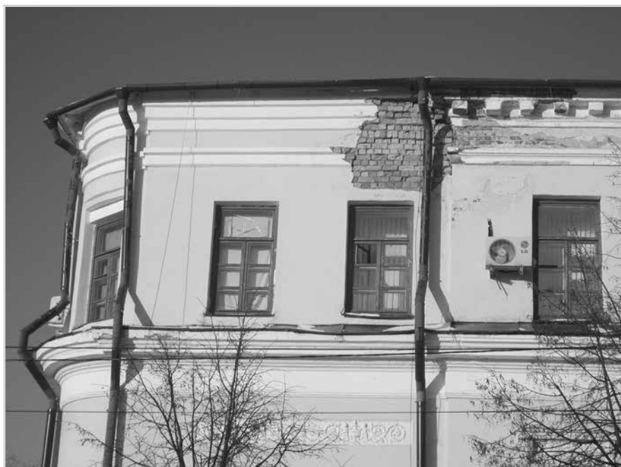
Ил. 9. Главный корпус больницы (верхняя часть западного «крыла» с отпавшей штукатуркой), вид с южной стороны. 24 января 2018 г. Семейный архив К. А. Степанова
